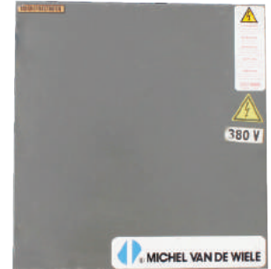
Atkı Motor Transformator 
